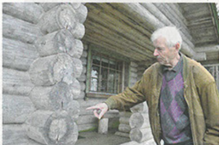
Rantamökin seinä on rapistunut. Jotain tällekin pitäisi tehdä, tuumii Jorma Reinikainen.
